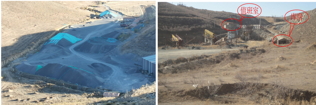
照片 4-1 破碎工业场地
