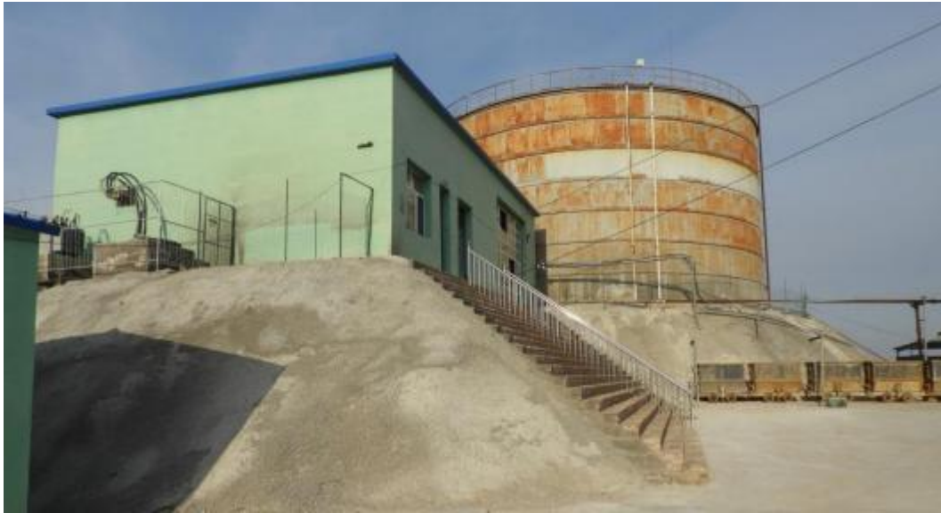
照片 1-8 高位水池
