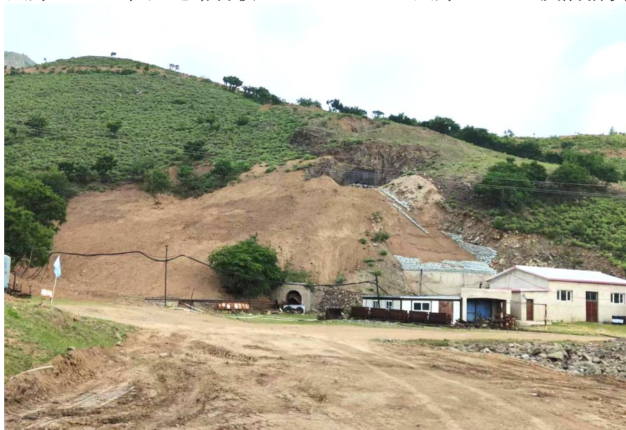
照片1-13 平硐工业场地（即现状原工业场地）北部边坡（含平硐PD2上方冲沟区域）治理效果
