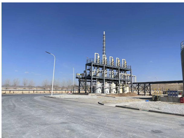
罐区废气处理设施
